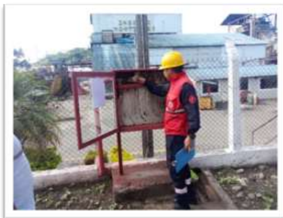
Inspección de gabinetes contra incendio en MALCA
