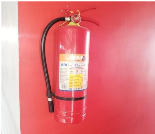
EXTINTORES PQS 10 LIBRAS
